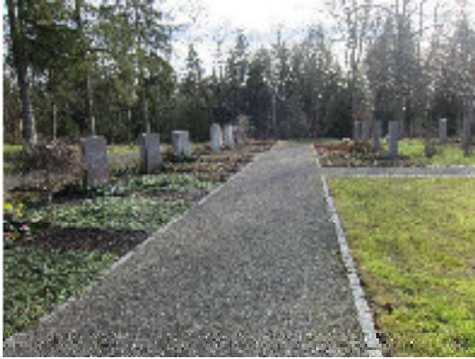
Abb. 153: Wegedecke in gutem Zustand
